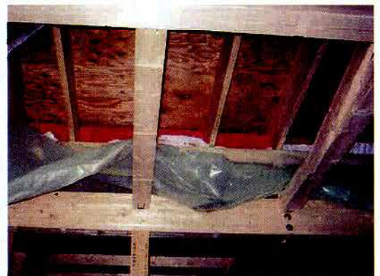
屋根の断熱の納まり。2×10の垂木の間にはスペーサーを入れて通気を確保したところに、グラスウール200mmを充てん。そこに防湿シートを張って気密を取り、内側に同45mmを付加する
